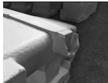
图2 挡石板发生变形、缺损
