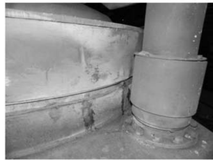
图1 炉衬材料中水分过高烘炉时水蒸气凝结
